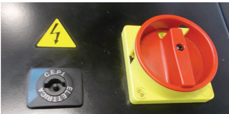
A : Quadro elettrico
