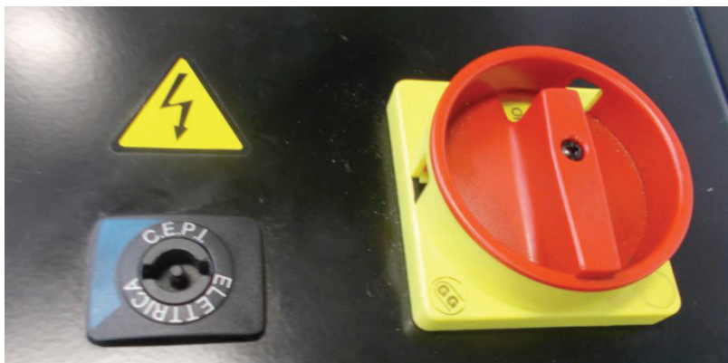
A: Cuadro eléctrico
