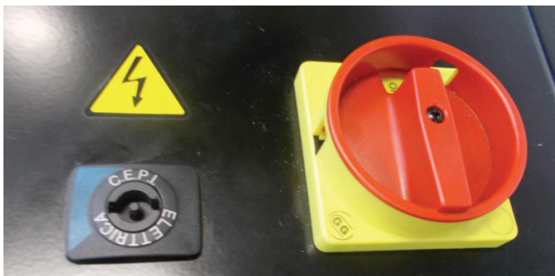
A : Tableau électrique
